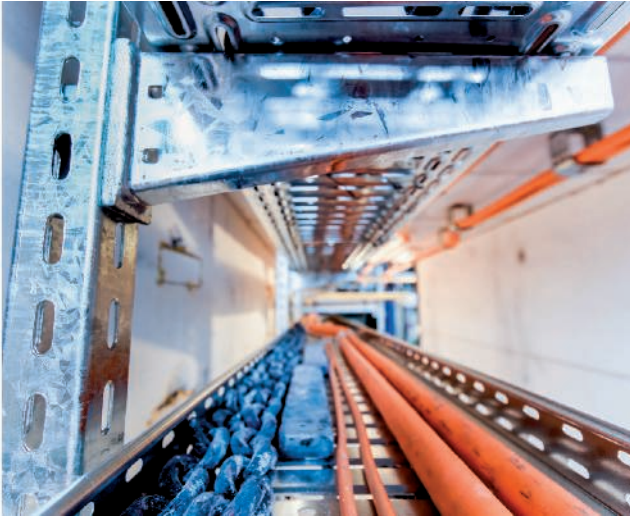
Cable de seguridad frente...
