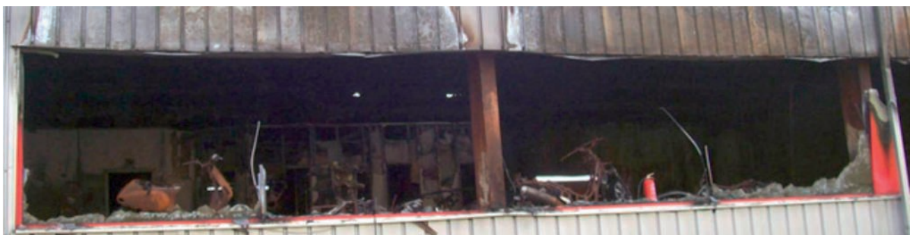
Daños de incendio por gases corrosivos
