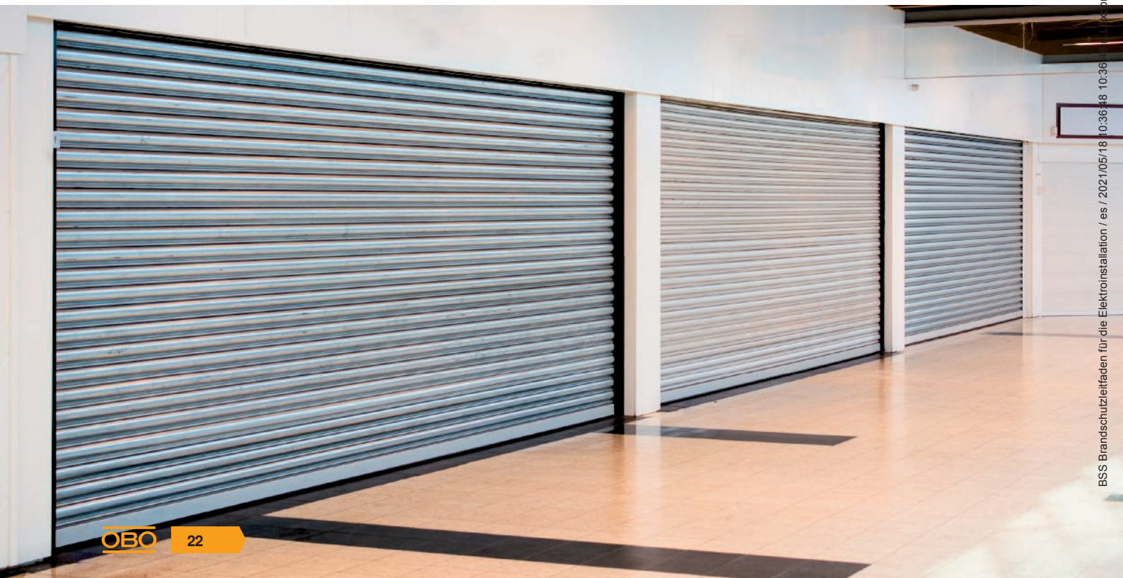
Compuertas deslizantes con clase de resistencia al fuego como barrera cortafuego
